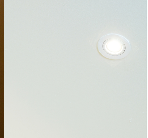
1 Ventilador por dormitorio. Ventiladores en el salon. Downlight en techos.
